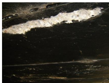
Figuur 347 dekkingsschade zij-onderkant plaatligger
