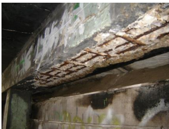
Figuur 7 brand- en dekkingsschade
