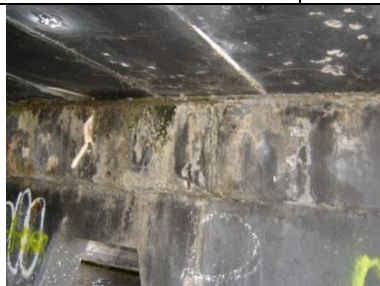
Figuur 10 lekkage tpv steunpunt
