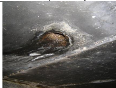
Figuur 11 chloride aantasting rondom waterafvoer
