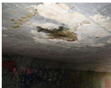
Figuur 2 schade rondom waterafvoergat
