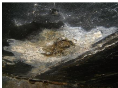
Figuur 18 chloride schade rondom waterafvoer
