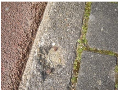
Figuur 22 schade voormalige bevestiging (hekwerk ?)
