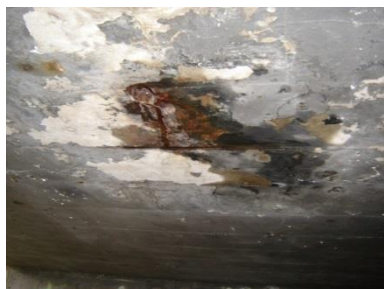
Figuur 5 Chlorideschade om afvoer gat
