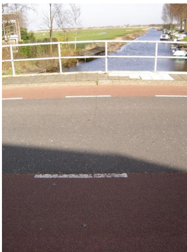
Figuur 524 scheurvorming boven steunpunt
