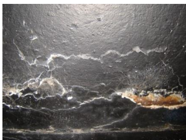
Figuur 16 dekkingsschade onderzijde dek
