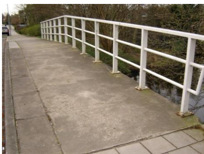
Figuur 8 leuningen gecorrodeerd, voetpad betonoppervlak verweerd
