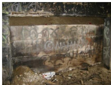
Figuur 6 brandschade en ontbreken grondopsluiting
