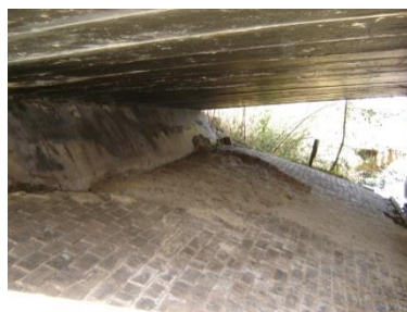
Figuur 19 dekkingsschade landhoofd en ontbreken taludbekleding
