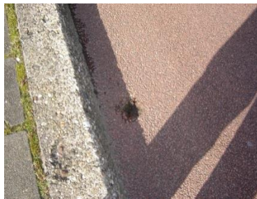
Figuur 23 waterafvoer dichtgeslibt
