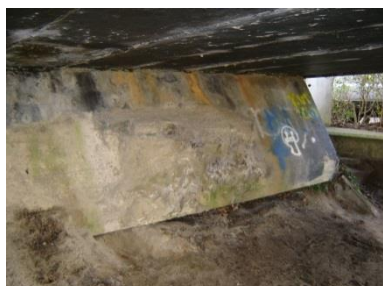
Figuur 12 lekwater tpv landhoofd, ontbrekende taludbekleding
